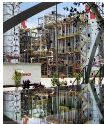
Centrale thermique de Norte Fluminense
