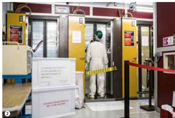
1. Portiques de détection en sortie de site. 2. portiques de détection en sortie de zone contrôlée.
