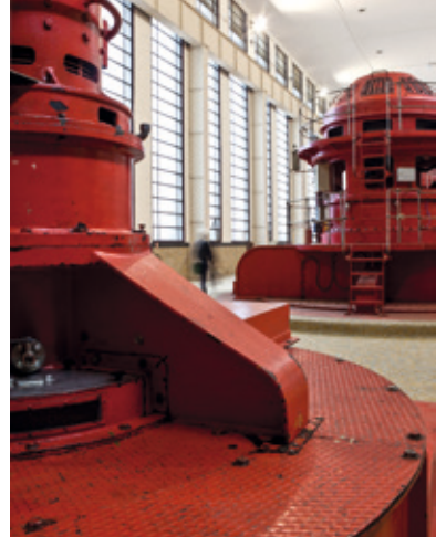
Salle des machines
