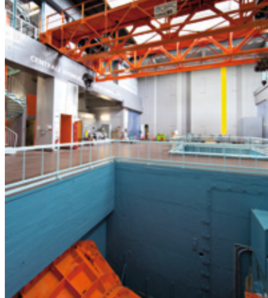
Salle des machines
