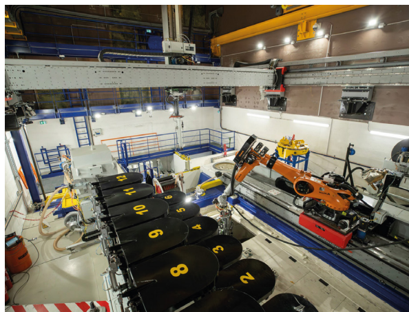
Vue de l'Atelier de Découpes du Terme Source (ADTS) avec l'un des robots
