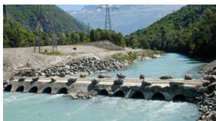
Exemple d'un passage busé
