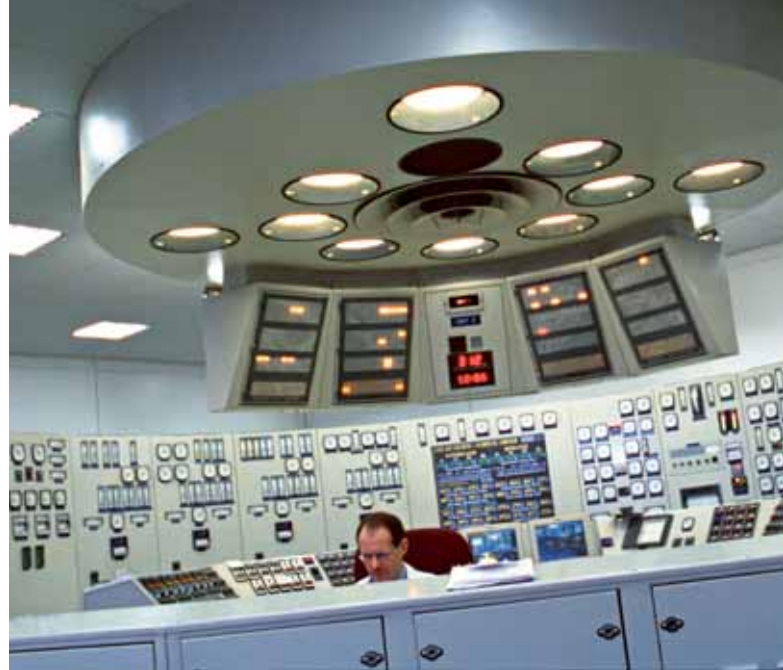
La salle de commande de la centrale thermique de Cottam, au Royaume-Uni. La centrale sera équipée d'installations de désulfuration des fumées.
