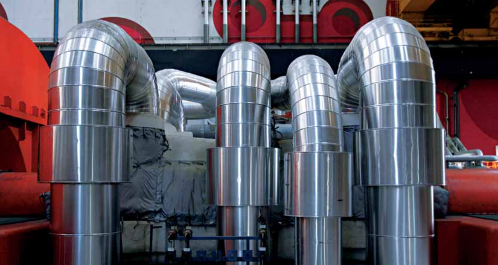
Salle des machines du centre nucléaire de production d'électricité de Tricastin, dans la Drôme.
