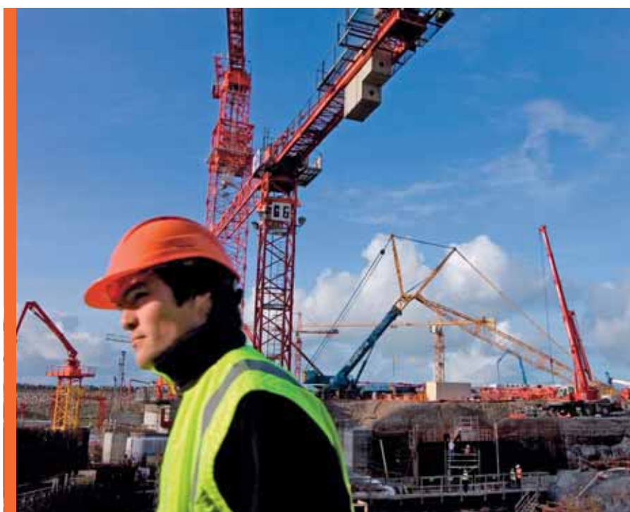
Lors du coulage du premier béton, sur le chantier de construction de l'unité type EPR à Flamanville.
