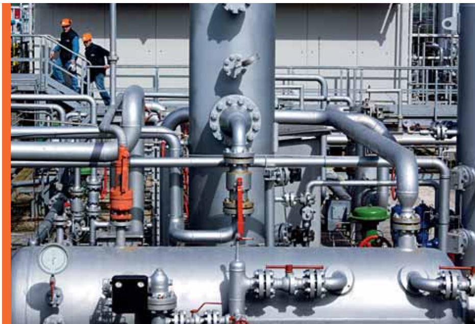
Centre de stockage de gaz de Cellino Attanasio. Edison prévoit d'investir 3,2 Md€ à l'augmentation de la production et des réserves en gaz naturel ainsi qu'à la sécurisation de ses approvisionnements.
