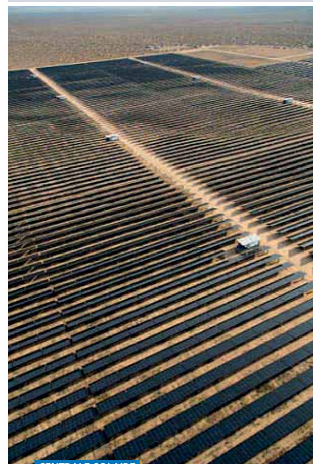
CENTRALE SOLAIRE À CATALINA (CALIFORNIE)
