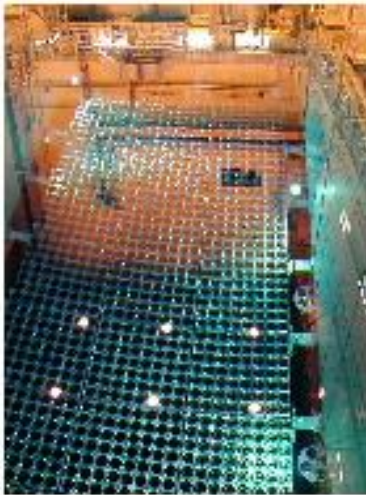
Bassin principal de la piscine d'entreposage
