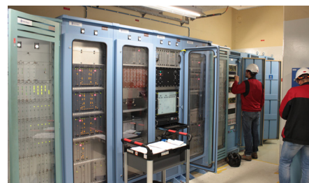
Armoires du contrôle-commande
