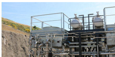
Système de refroidissement sur le toit du DUS
