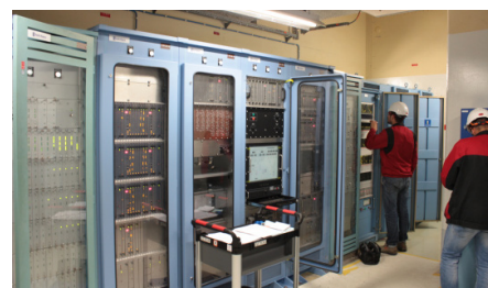
Armoires du contrôle-commande
