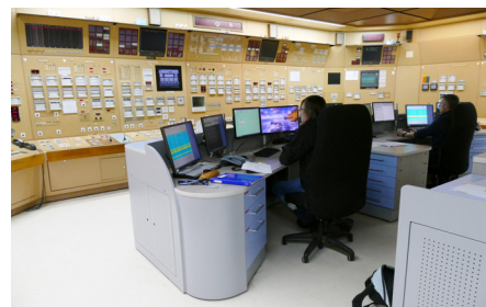
Salle de commande rénovée
