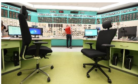
En salle de commande les équipes se succèdent 24h/24 et 7 jours/7 pour gérer le pilotage et le suivi des installations.
