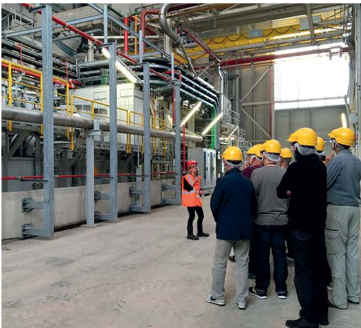
En salle des machines, les visiteurs sont à proximité des deux turbines et de l'alternateur.
