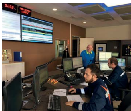
1 er TWh : En salle de commande, la production d'électricité est ajustée en temps réel pour répondre aux besoins du réseau
