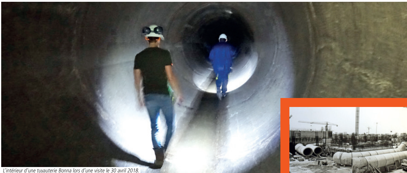
L'intérieur d'une tuyauterie Bonna lors d'une visite le 30 avril 2018.
