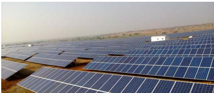
Centrale solaire de Khilchipur dans le Madhya Pradesh
