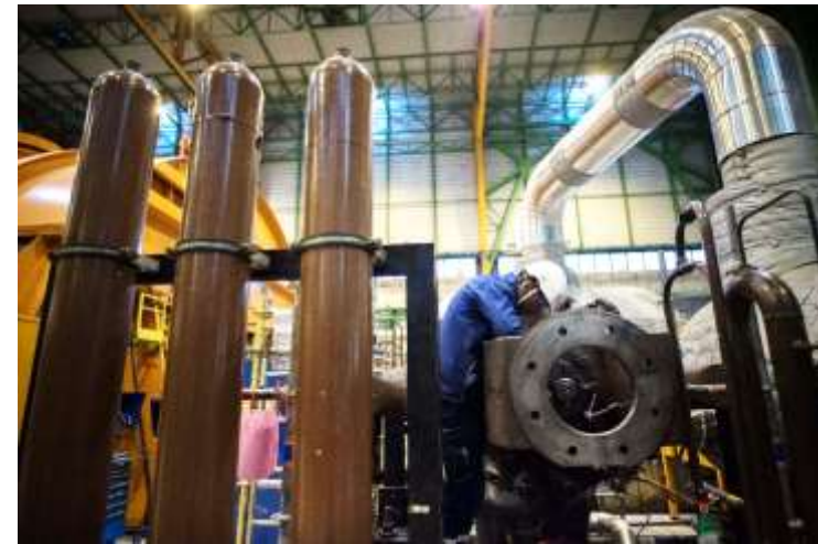
CNPE de Saint Laurent des Eaux, intervention en salle des machines, dans le cadre des travaux du Grand Carénage
