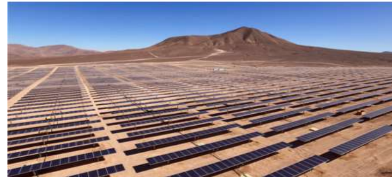
Parc solaire de Bolero (désert d'Atacama)
