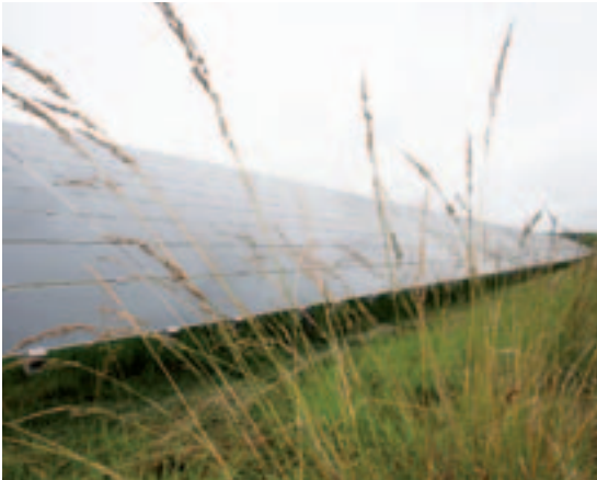
Centrale photovoltaïque de Bouloc
