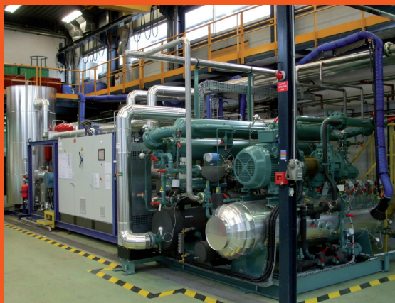
Pompe à chaleur Johnson Control Industries 120°C au R245fa EDF R&D Les Renardières.
