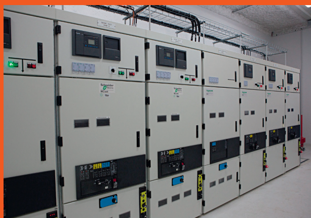
Contrôle-commande d'un poste source de distribution
