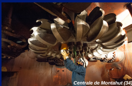
Centrale de Montahut (34)
