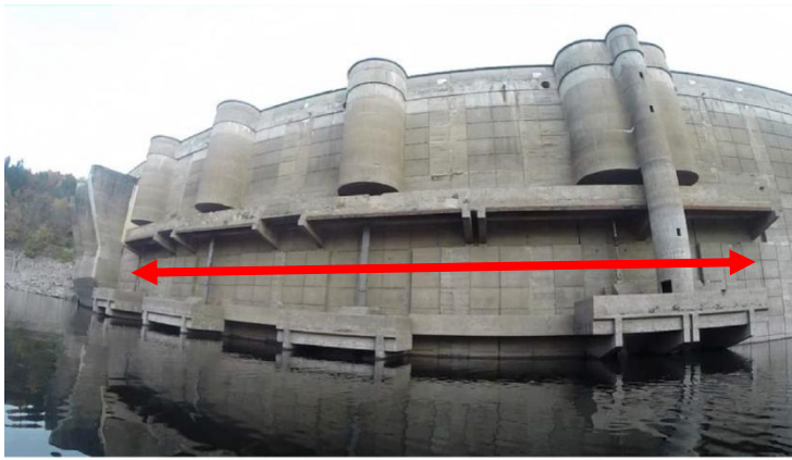
Vue amont du barrage de Bort. En rouge, les « terrasses » qui vont faire l'objet de restauration en vue du chantier 2018
