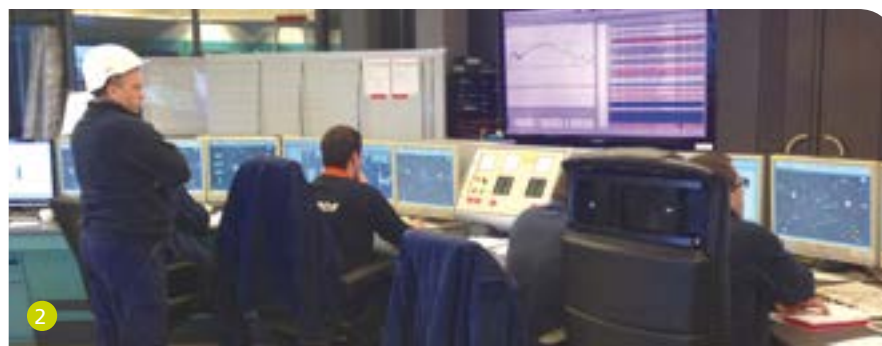
2 La salle de commande de la centrale de Seraing. Ce cycle combiné est une unité de production « black start » qui peut démarrer sans être alimentée en électricité via une source externe, grâce aux moteurs diesel dont elle est équipée. Ces moteurs sont régulièrement démarrés pour test.
