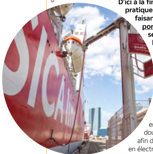
Branchement électrique d'un ferry à quai.
